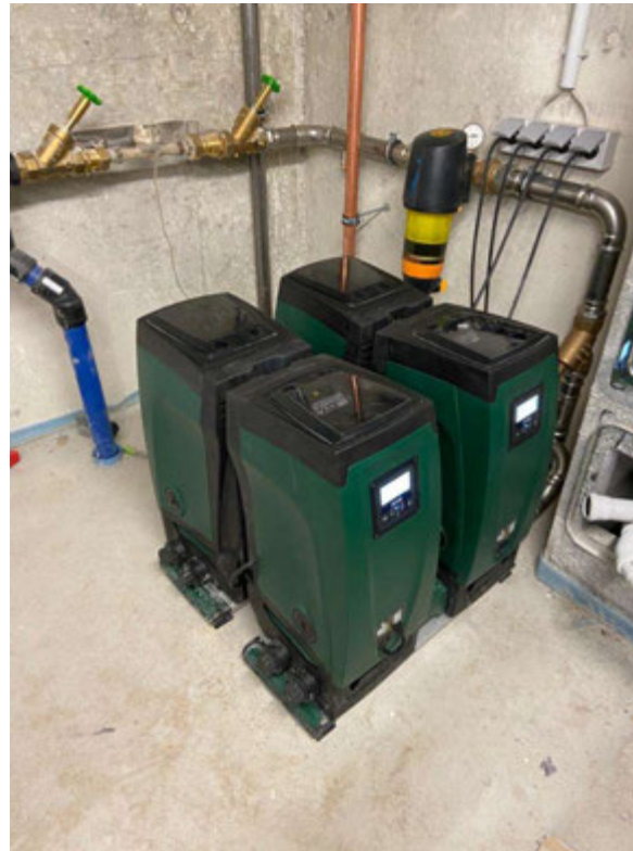
Trinkwasser Druckerhöhungsanlage für 75 Wohneinheiten
