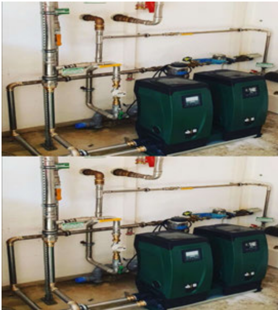
Trinkwasser Druckerhöhungsanlage in einer Villa
